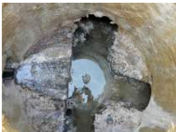
Foto 3 - Valutazione stato iniziale del pozzetto
