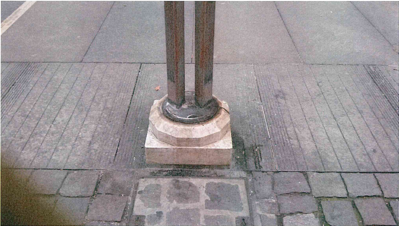
C.so A. Pio – particolare della pavimentazione in lastre di luserna del marciapiede sul lato est con in primo piano il basamento dei pali dell'illuminazione pubblica da riparare previa pulizia accurata con prodotti idonei.
