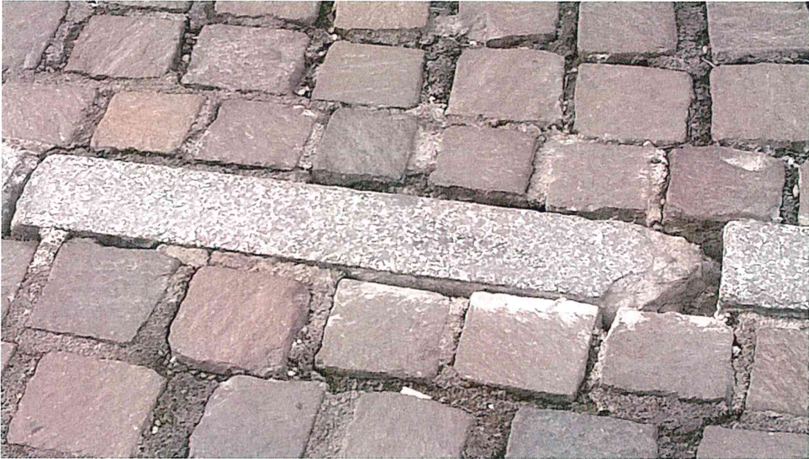
C.so Fanti – cordoli di mezzaria stradale da sostituire e pavimentazione in porfido con stuccatura da rimuovere
