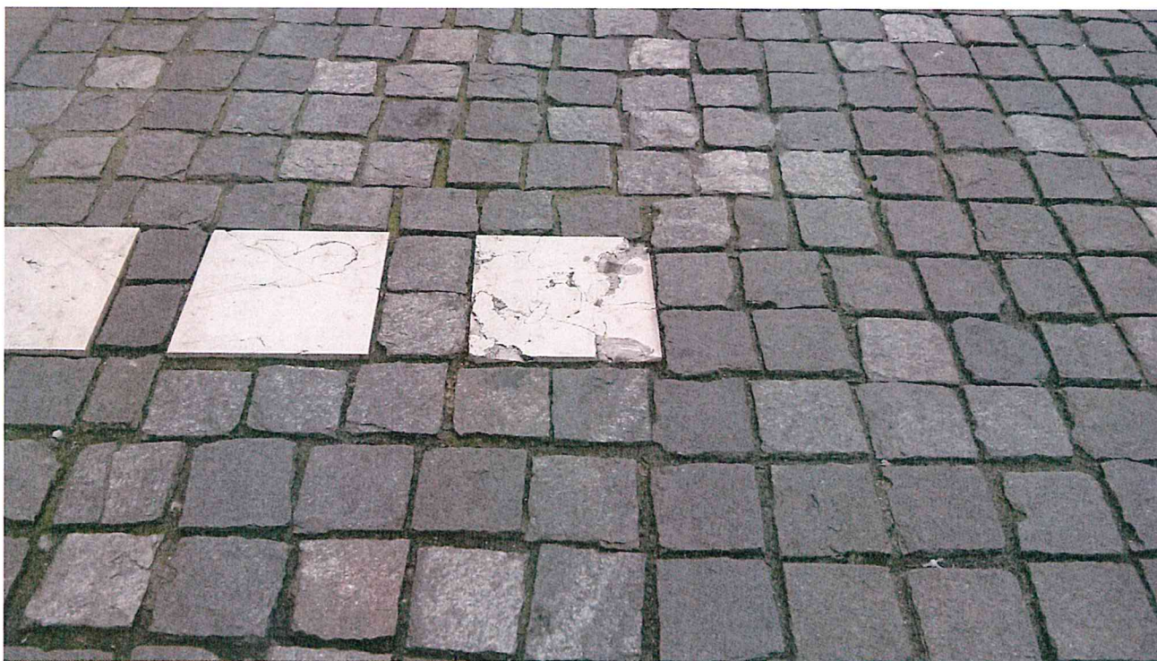
C.so A. Pio – quadrotti in pietra d'Istria Orsera da recuperare ed integrare
