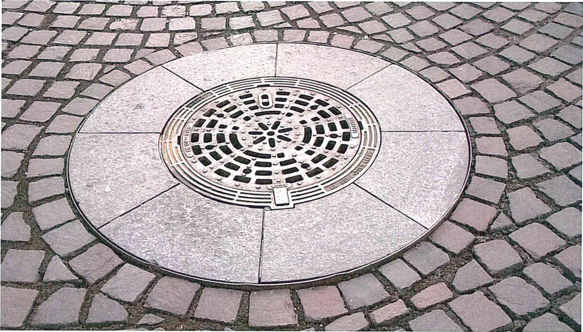
C.so Fanti – particolare rosoni agli incroci da ripristinare
