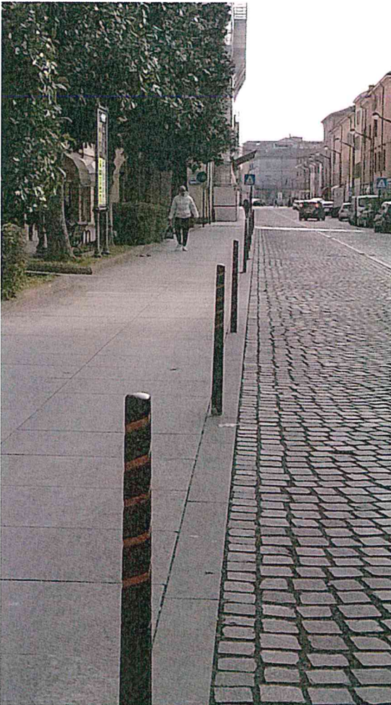
C.so Fanti – delimitatori metallici da sostituire
