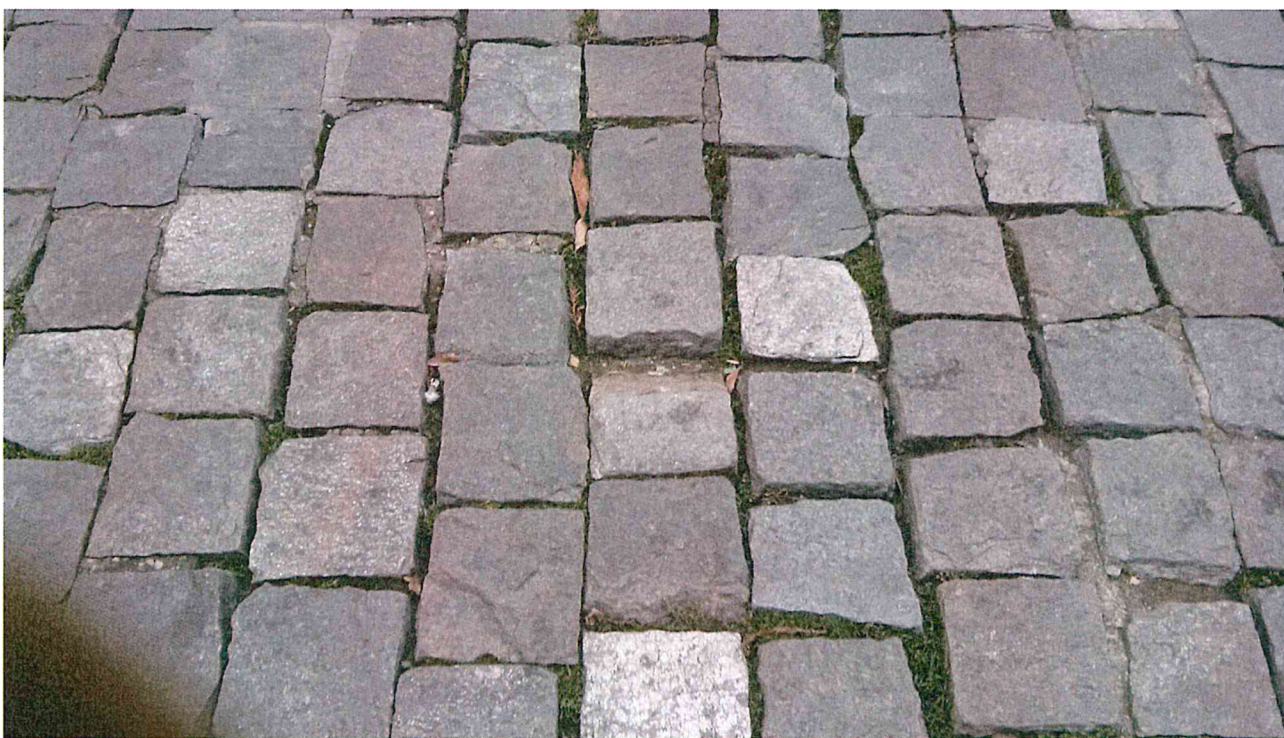
C.so A. Pio – particolare della pavimentazione in cubetti di luserna 10-12 da riparare mediante il rifacimento della stuccatura a boiaccia di cemento previa pulizia accurata degli interstizi.
